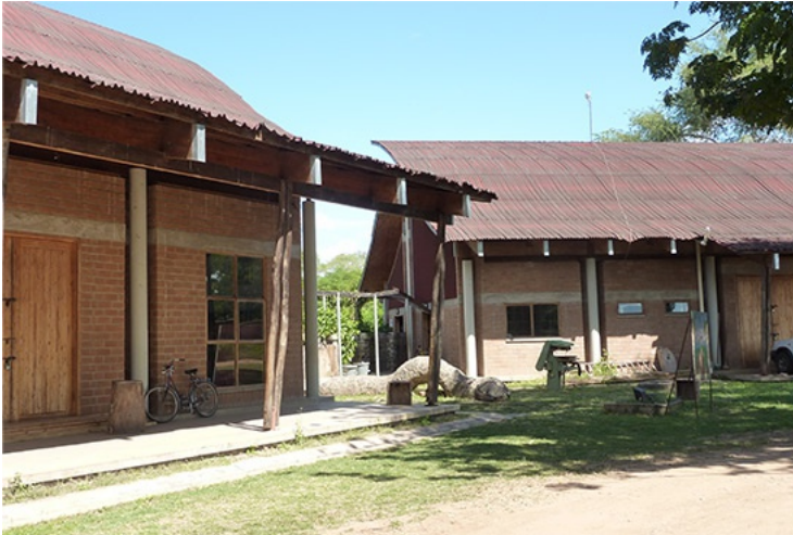
Vorher: Die Dächer der beiden Gebäude sind stellenweise aufgequollen und undicht.
